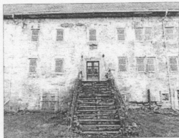
Die Fassaden sind nach wie vor in einem erbärmlichen Zustand. Wenigstens das Regenwasser wird nun abgeleitet.
